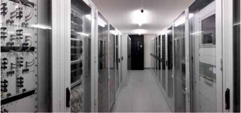
Abb. 9 ► Serverraum der ILS Schweinfurt
