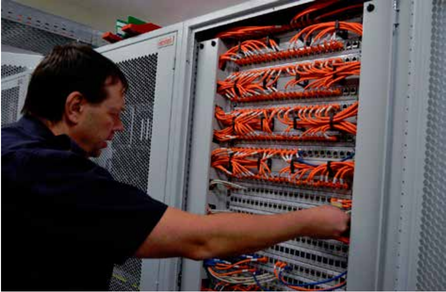
Abb. 11 ► Patchfelder erleichtern Umbauten und Ergänzungen.
